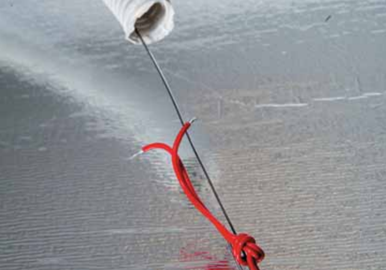
Рис. 15. Установка датчика температуры пола SF-4x15 в гофрированную трубку (начало).
